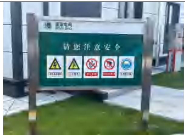
变电站内警告标识
