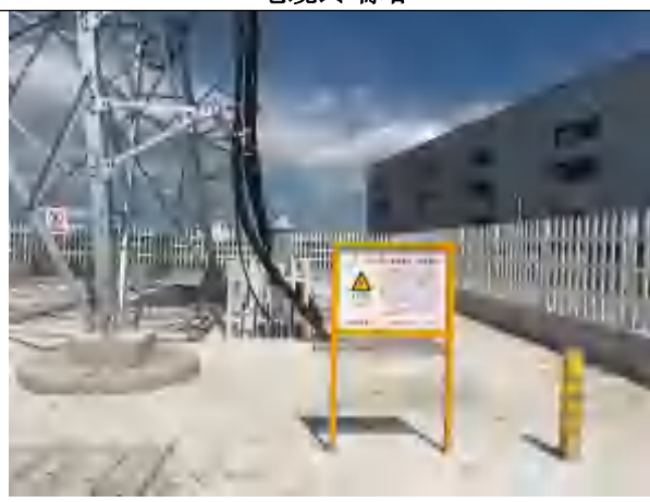
塔基警告标识
