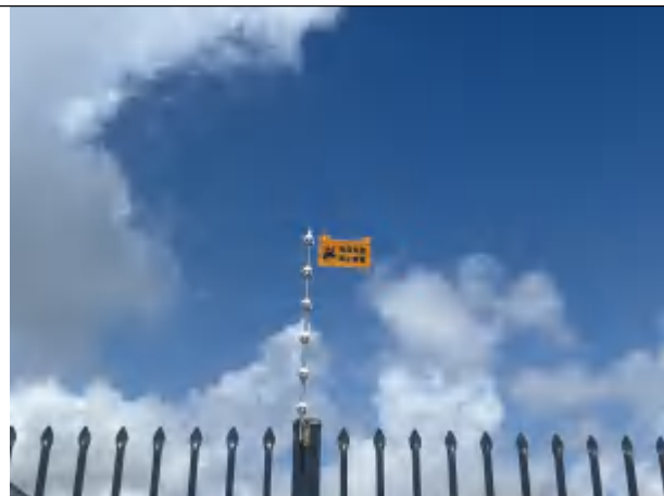
变电站警告标识
