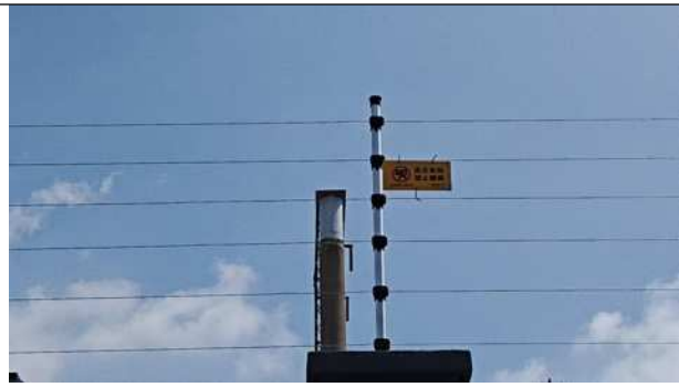
变电站警告标识
