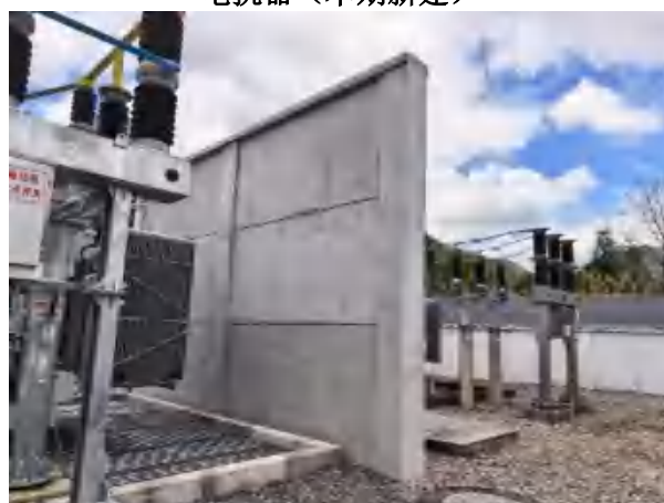
电抗器防火墙
