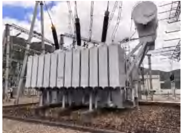
2 号主变及事故油坑
