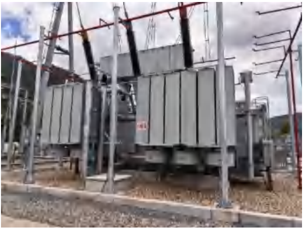
3 号主变及事故油坑（本期新建）
