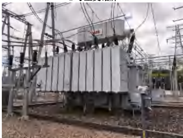
1 号主变及事故油坑
