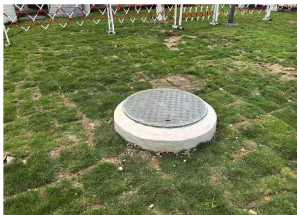
本期新增事故油池
