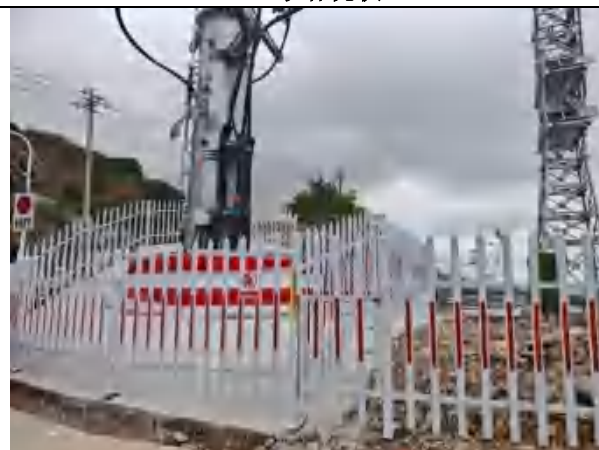
T29-35kV 电缆终端塔现状
