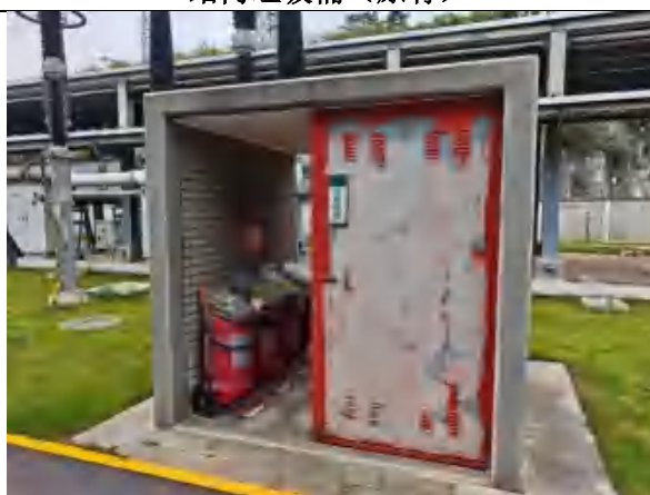
站内消防砂箱（原有）
