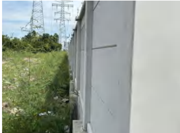
启城变电站厂界西侧
