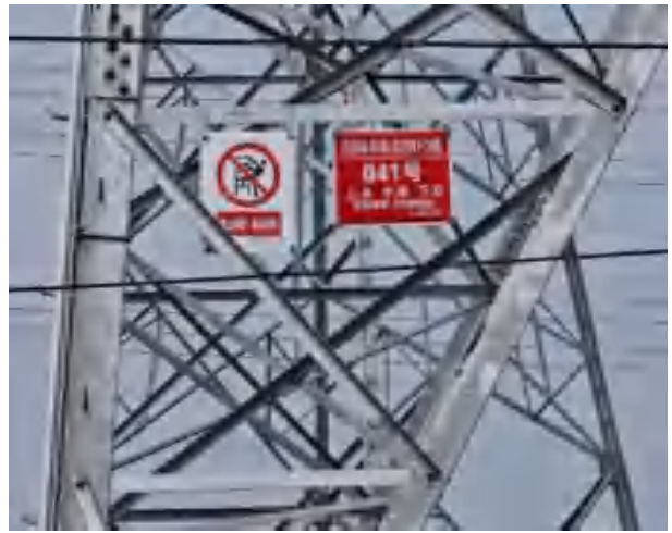
塔基危险标识
