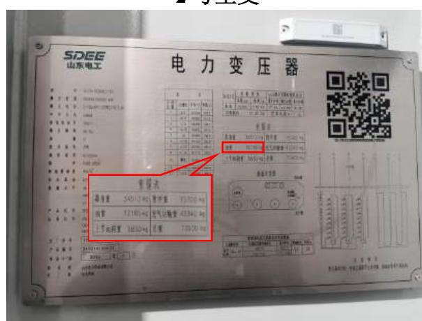
2 号主变铭牌（油重 15.165T）
