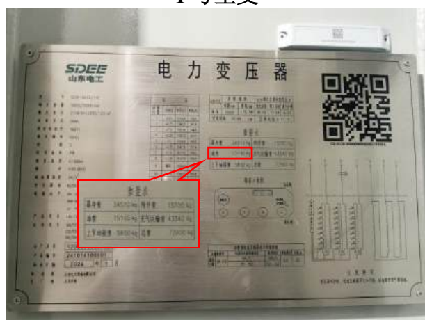
1 号主变铭牌（油重 15.165T）
