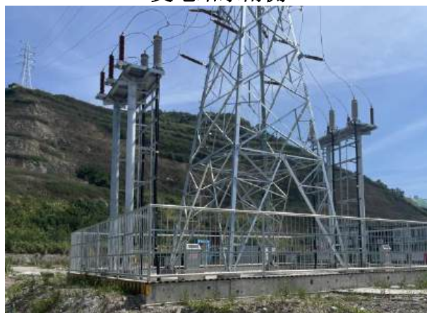
电缆终端塔基现状
