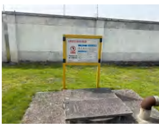
电抗器事故油池
