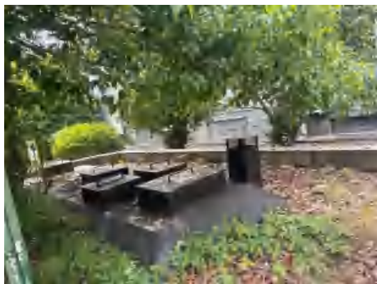
生活污水处理系统
