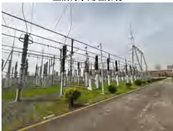
220kV 配电装置区
