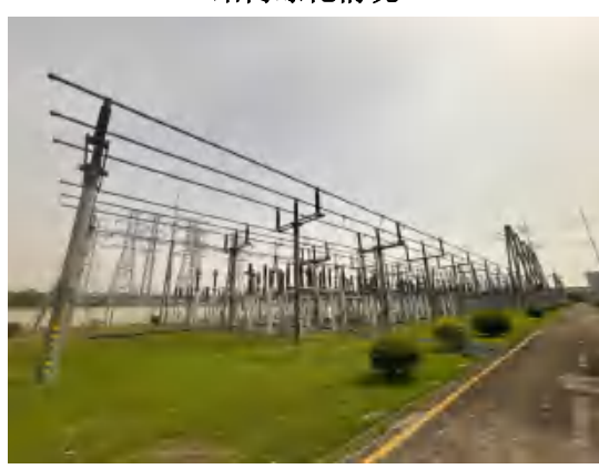
110kV 配电装置区
