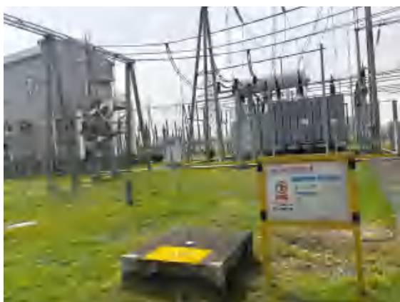
主变事故油池
