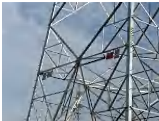
G27#塔基标识牌、相序牌、危险标识
