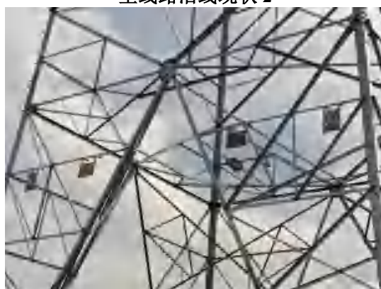
G9#塔基标识牌、相序牌、危险标识
