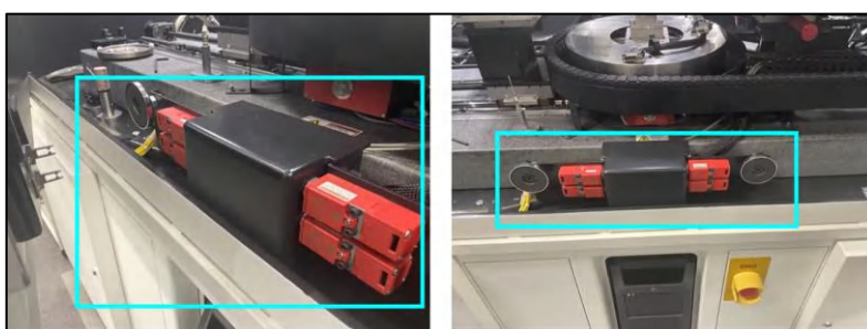
图 10-2 正面及背面防护门处门-机联锁装置（常闭双触点开关）
