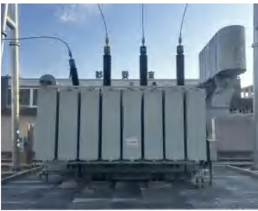
2 号主变（本期扩建）
