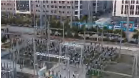
110kV 配电装置区
