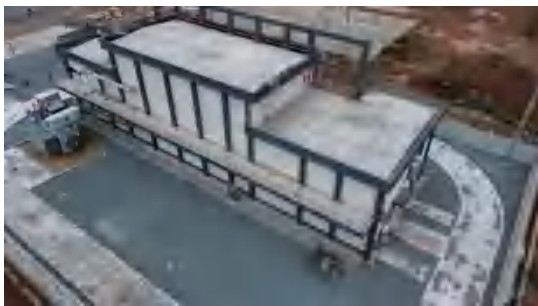
110kV 配电装置
