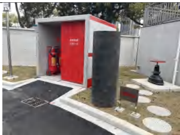
站内消防设施
