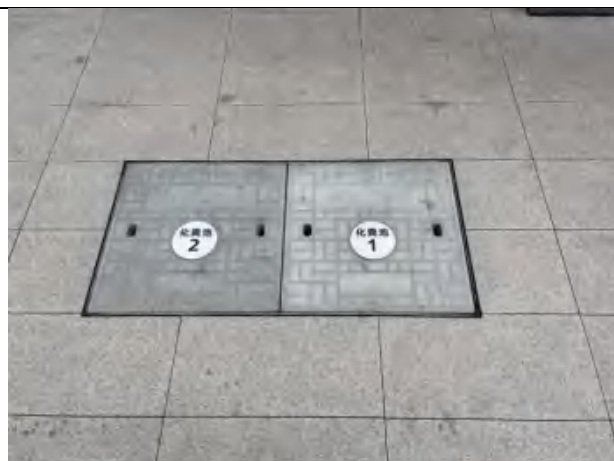
上陡门 110kV 变电站化粪池
