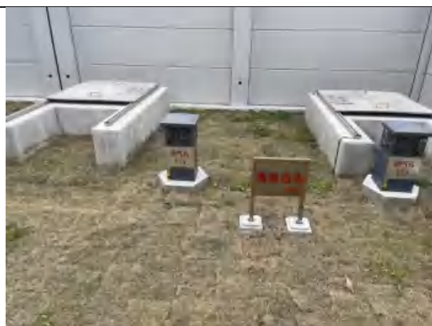
上陡门 110kV 变电站事故油池 (23.99m 3 )
