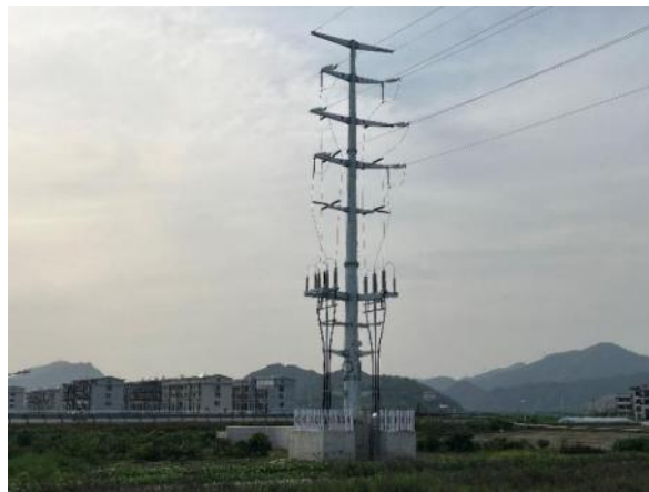
电缆终端塔基现状
