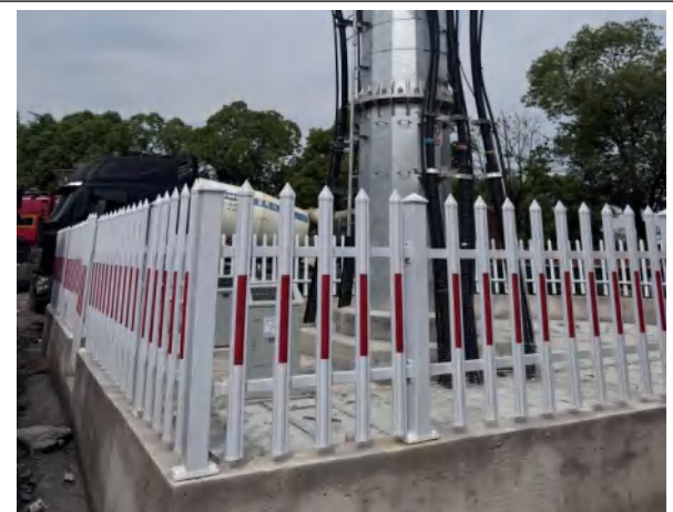
电缆终端塔基现状
