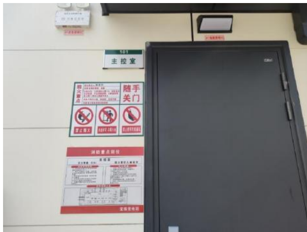
变电站警告标识
