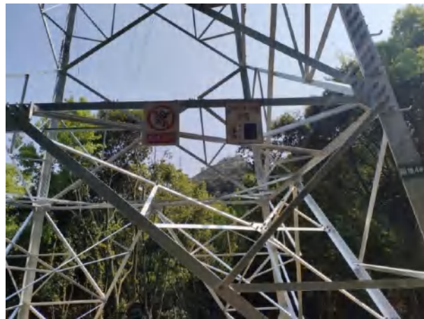
塔基危险标识
