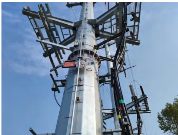
电缆终端塔危险标识
