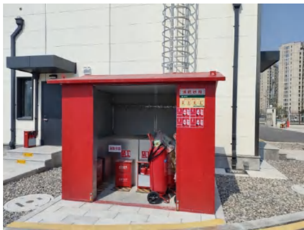
站内消防设施
