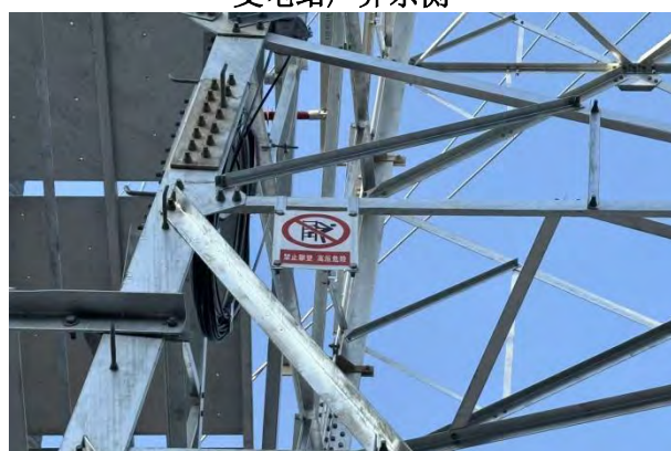
塔基危险标识 1
