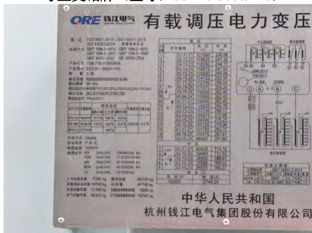
1 号主变铭牌油重局部放大图（油重 19.74T）
