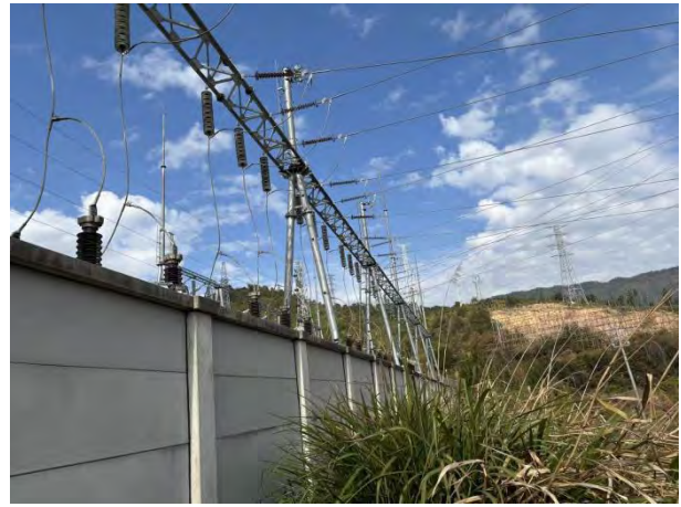
大安 220kV 变电站扩建间隔侧
