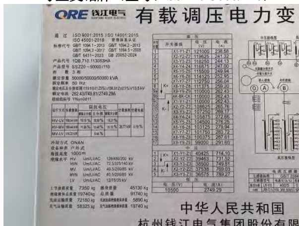
2 号主变铭牌油重局部放大图（油重 19.74T）
