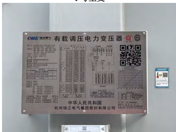
1 号主变铭牌（型号：SSZ20-5000/110）
