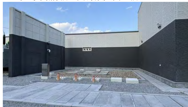
三号主变位置
