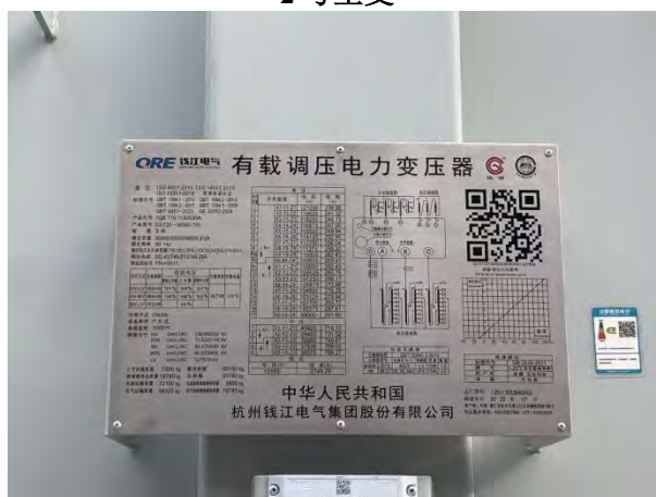
2 号主变铭牌（型号：SSZ20-5000/110）
