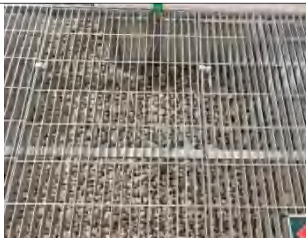
主变事故油坑
