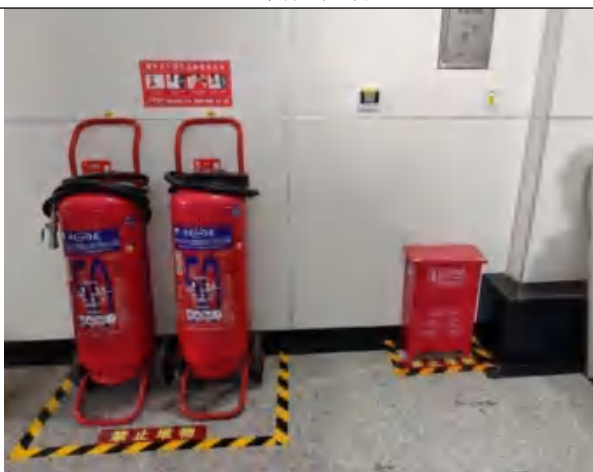
站内消防设施
