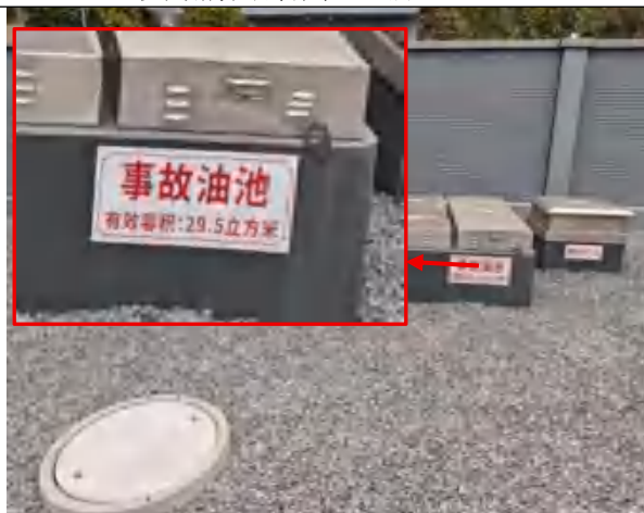
事故油池（有效容积 29.5m 3 ）
