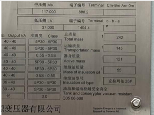
1#主变铭牌（局部放大图，油重 55t）
