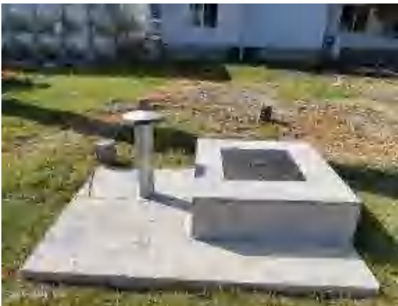
220kV 升谷变电站本次改造事故油池
