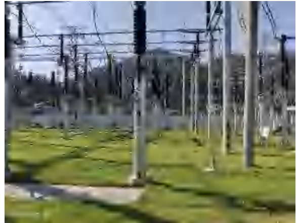
220kV 升谷变电站站内绿化
