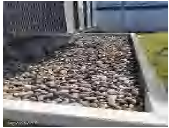
220kV 升谷变电站电抗器事故油坑
