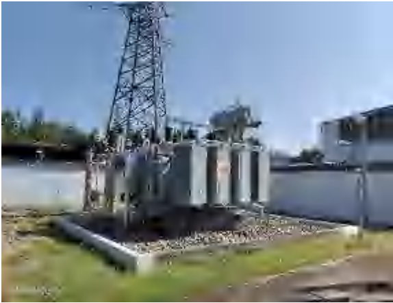
220kV 升谷变电站 本次改造电抗器
