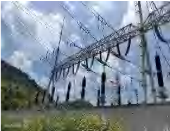
500kV 长潭变电站改造间隔出线侧
