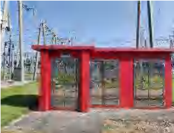
220kV 升谷变电站消防沙箱
